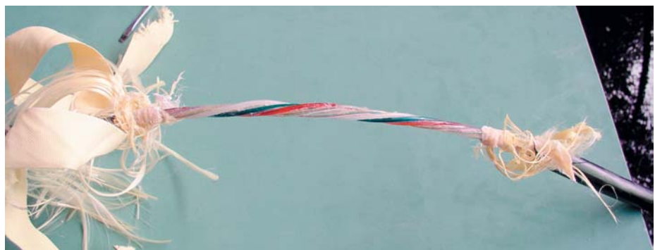
■ Kabel propucan sačmom 2
